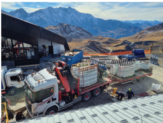
Le garage de la télécabine de Varet situé à quasi 2 700 m d'altitude, donne accès à une nouvelle attraction, une tyrolienne permettant de descendre à vol plané l'Aiguille Rouge sur 1,8 km.
