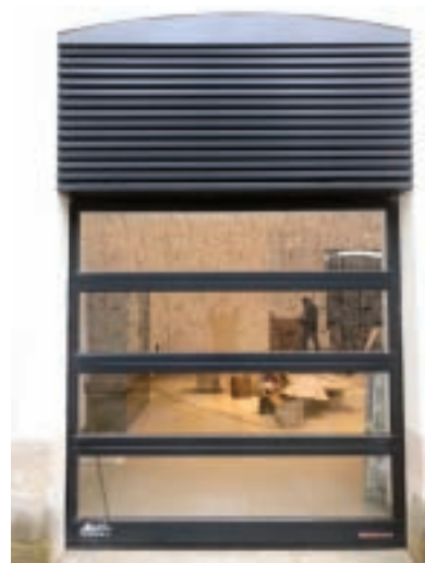
Pose d'une porte sectionnelle Hörmann avec section vitrage intégrale pour un magasin dans le centre-ville de Nantes.
