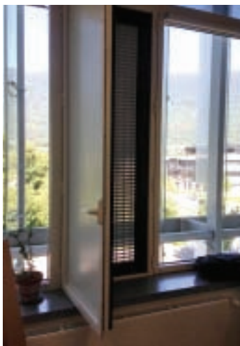
Les grilles anti-intrusion dans les menuiseries pour la ventilation.
