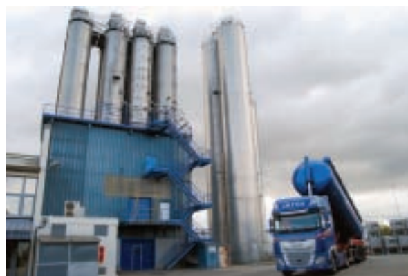
Usine de Marmoutier (67). Arrivée de la matière première qui fait l'objet d'un contrôle très pointu sur le matériau avant le transfert en silos. Capacité de stockage de 325 t de résine PVC sur ce site.
