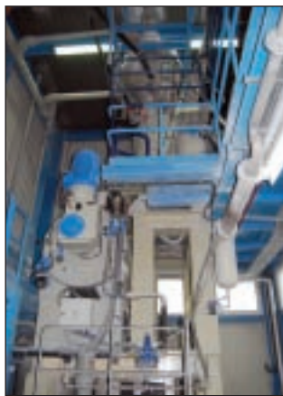
Salle de mélange des composants du PVC qui alimentera les extrudeuses françaises.
